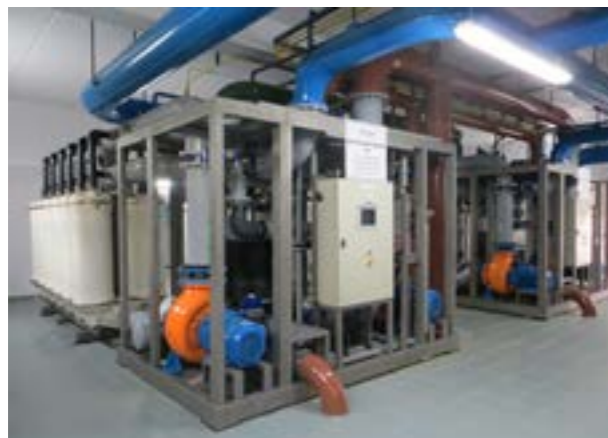
Unités d'ultrafiltration – Usine de la Jatte ROUEN
