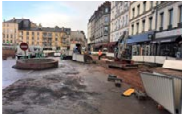
Les travaux de réseaux sur le nord de la Place du Vieux-Marché
