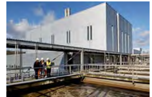
Station d'épuration Émeraude
