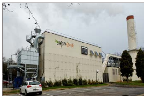
Chaufferie de Cantelieu
