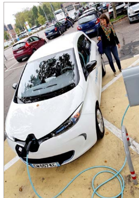
Borne de recharge pour véhicules électriques
