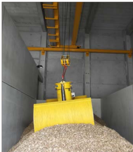
Nouvelle chaufferie biomasse
