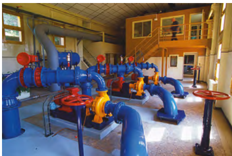
Station d'eau potable de La Jatte
