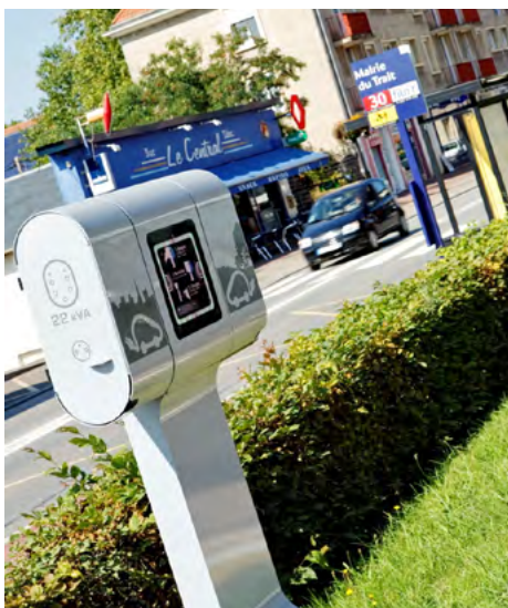
Nouvelle borne de recharge pour véhicules électriques implantée au Trait, place de l'Amiral Ronar'ch, en octobre 2015
