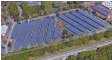
Ombrières photovoltaïques de l'usine Renault de Cléon
