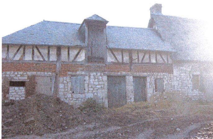
Friches : bâti laissé à l'abandon
