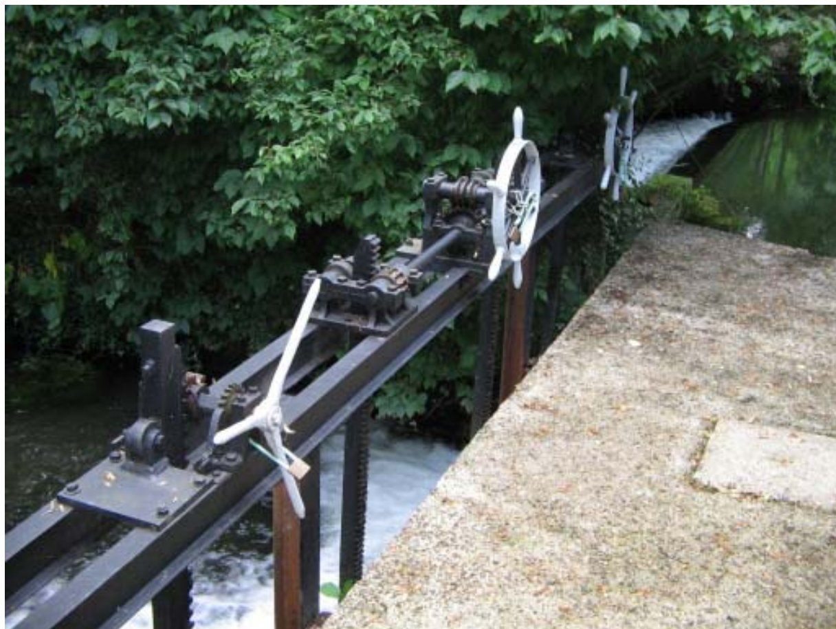
système de manoeuvre des vannes levantes
