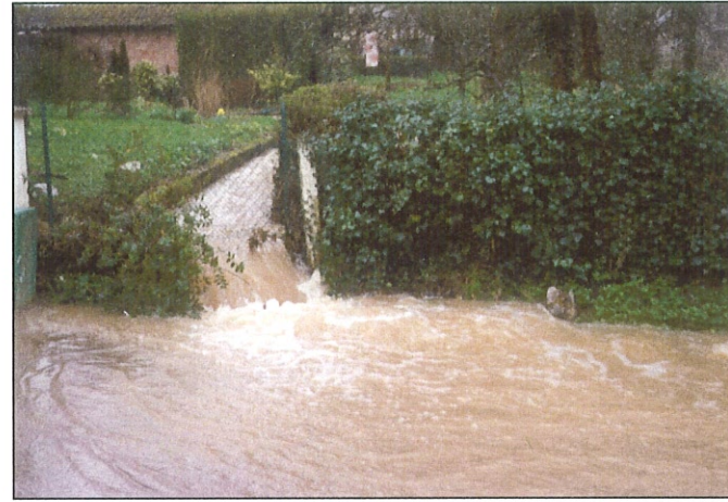
Photo 38 Exutoire du fossé directement sous la petite ruelle.
