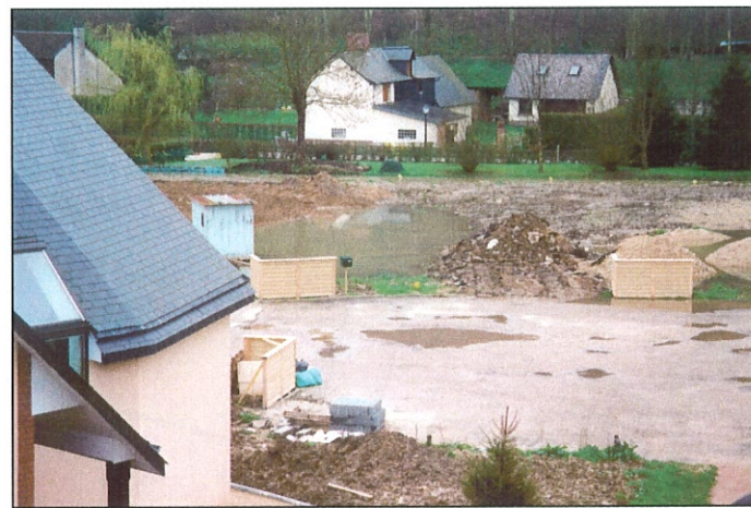
Photo 77 Terrains du lotissement en construction en partie inondés.
