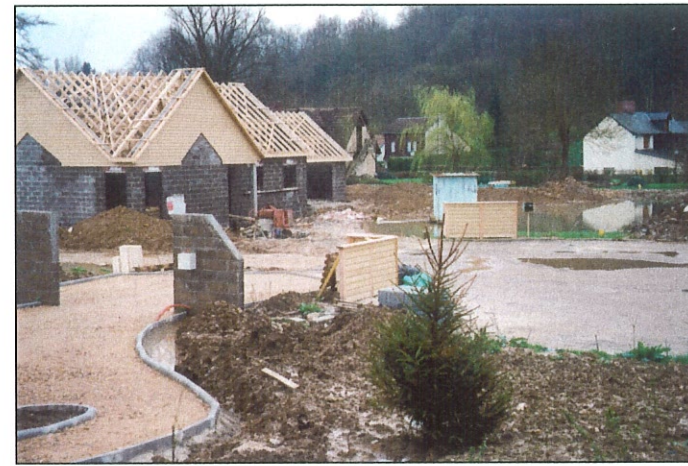
Photo 78 Terrains du lotissement en construction en partie inondés.
