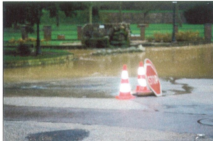
Photo 45 Inondation de la place de la Fontaine et du carrefour avec la RD 61 + débordement du réseau d'eaux pluviales.
