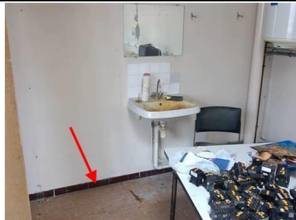
Photo n° PhA014 Localisation : Batiment C2 RDC - Vestiaires Ouvrage : Revêtements de murs ( plinthes ) Partie d'ouvrage : Colles des carrelages ( plinthes ) Description : Colles des carrelages ( plinthes ) Localisation sur croquis : P015
