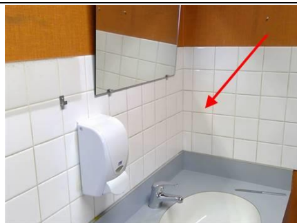
Photo n° PhA065 Localisation : Bâtiment C1 1er étage - Sanitaires Ouvrage : Revêtements de murs Partie d'ouvrage : Colles des faïences Description : Colles des faïences Localisation sur croquis : P068
