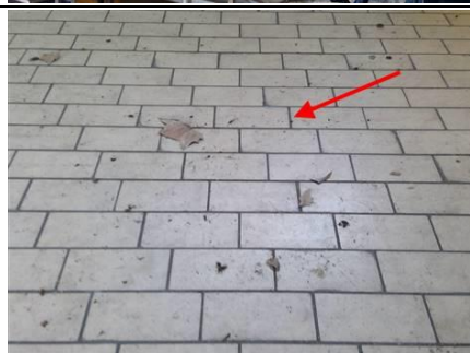
Photo n° PhA017 Localisation : Bâtiment C1 RDC - Hall appel Ouvrage : Revêtements de murs Partie d'ouvrage : Colles des carrelages Description : Colles des carrelages Localisation sur croquis : P018
