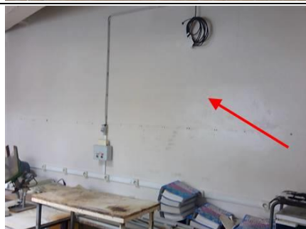
Photo n° PhA016 Localisation : Batiment C2 RDC - Réserve Ouvrage : Revêtements de murs Partie d'ouvrage : Peinture + enduit Description : Peinture + enduit Localisation sur croquis : P017
