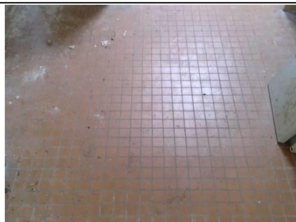
Photo n° PhA015 Localisation : Batiment C2 RDC - Vestiaires Ouvrage : Revêtements de sol Partie d'ouvrage : Colles des carrelages Description : Colles des carrelages Localisation sur croquis : P016
