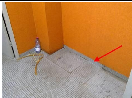
Photo n° PhA066 Localisation : Bâtiment C1 1er étage - Sanitaires Ouvrage : Revêtements de murs ( plinthes ) Partie d'ouvrage : Colles des plinthes Description : Colles des plinthes Localisation sur croquis : P069
