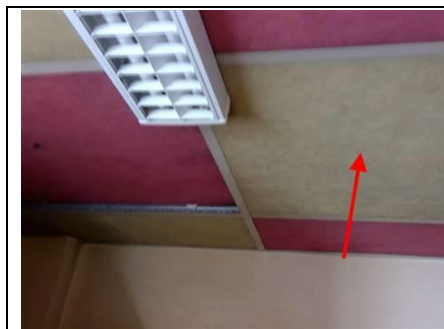
Photo n° PhA058 Localisation : Bâtiment C2 1er étage - Dégagement Ouvrage : Flocages, Calorifugeages, Faux plafonds Partie d'ouvrage : Faux plafonds Description : Faux plafonds Localisation sur croquis : P060
