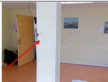
Photo n° PhA063 Localisation : Bâtiment C1 1er étage - Bureau 1 Ouvrage : Poteaux (périphériques et intérieurs) Partie d'ouvrage : Enduits Description : Enduits Localisation sur croquis : P066
