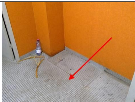
Photo n° PhA067 Localisation : Bâtiment C1 1er étage - Sanitaires Ouvrage : Revêtements de sol Partie d'ouvrage : Colles des carrelages Description : Colles des carrelages Localisation sur croquis : P070
