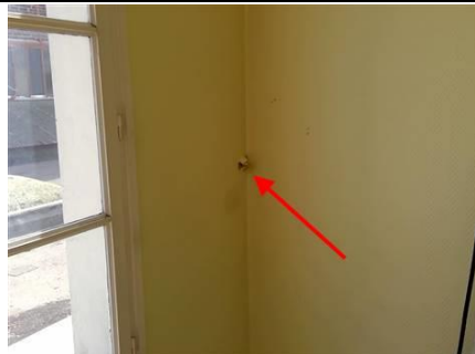
Photo n° PhA064 Localisation : Bâtiment C1 1er étage - Bureau 4 Ouvrage : Cloisons légères ou préfabriquées Partie d'ouvrage : Jonctions entre panneaux préfabriqués et pieds/têtes de cloisons (carton) Description : Jonctions entre panneaux préfabriqués et pieds/têtes de cloisons (carton) Localisation sur croquis : P067
