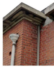
Etat actuel, fissures
