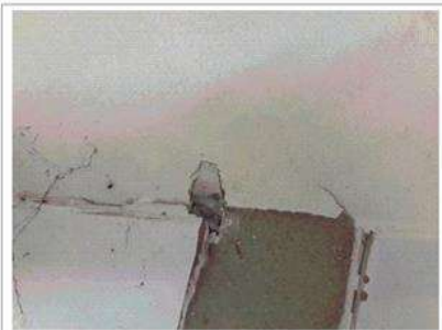
Prélèvement - P017 : Rez-de-chaussée / Cuisine - Plot de colle - (Absence d'amiante)
