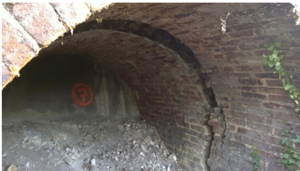
Fissures dans les voûtes
